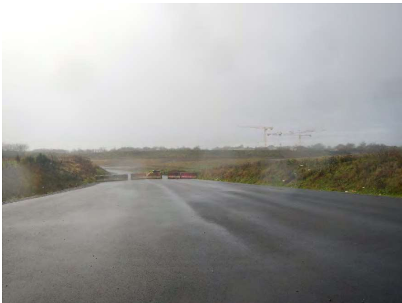
Figure 121 : Travaux de la rocade Ouest de Saint-Brieuc au niveau des Plaines-Villes (Source : EGIS, janvier 2022)
